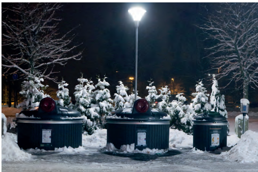
Nedgrävda behållare för avfall.
